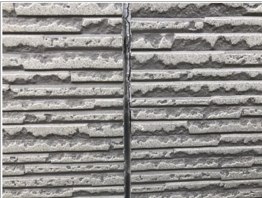
外壁 ボードシーリング劣化部
