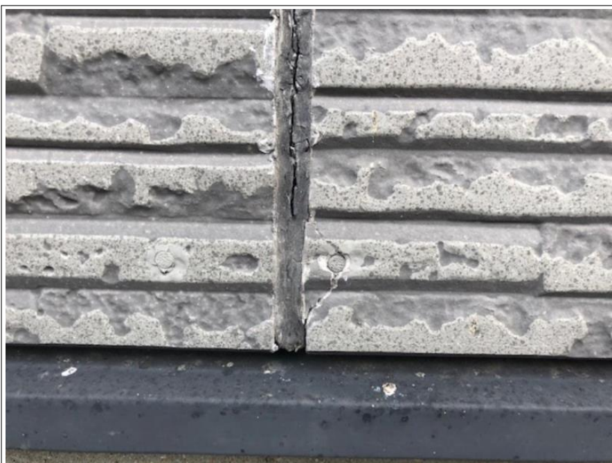
外壁 ボードシーリング劣化部
