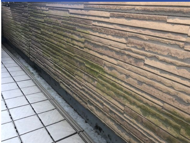
外壁 カビ発生部
