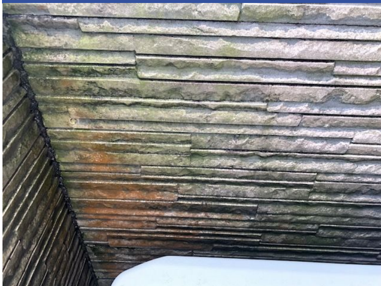
外壁 カビ発生部
