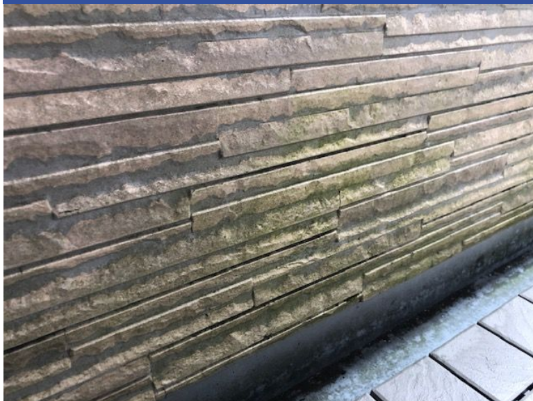
外壁 カビ発生部
