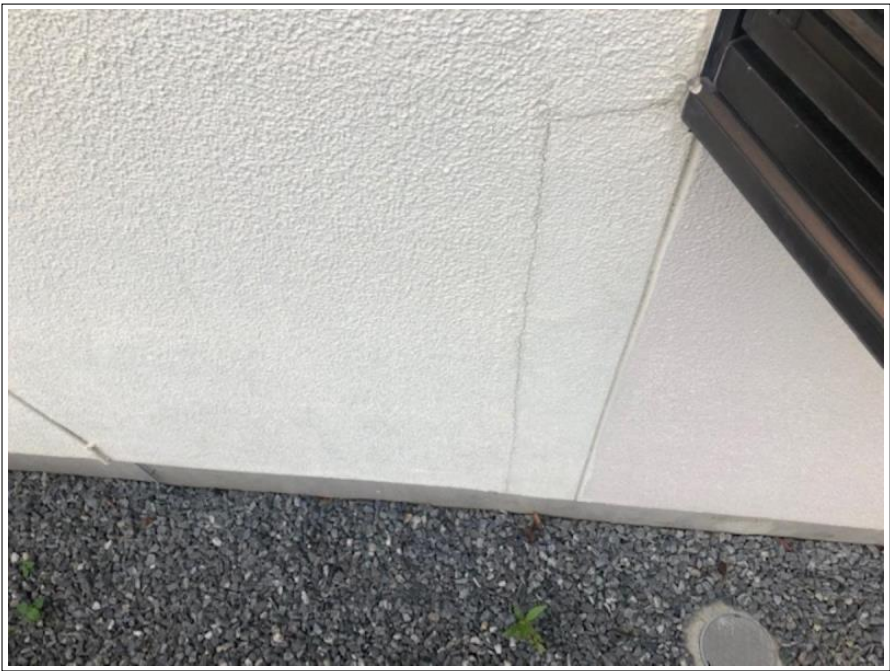
外壁 クラック部
