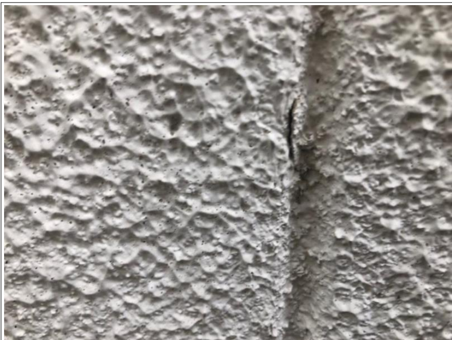
外壁 クラック部
