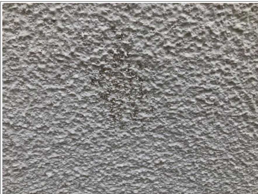
外壁 カビ発生
