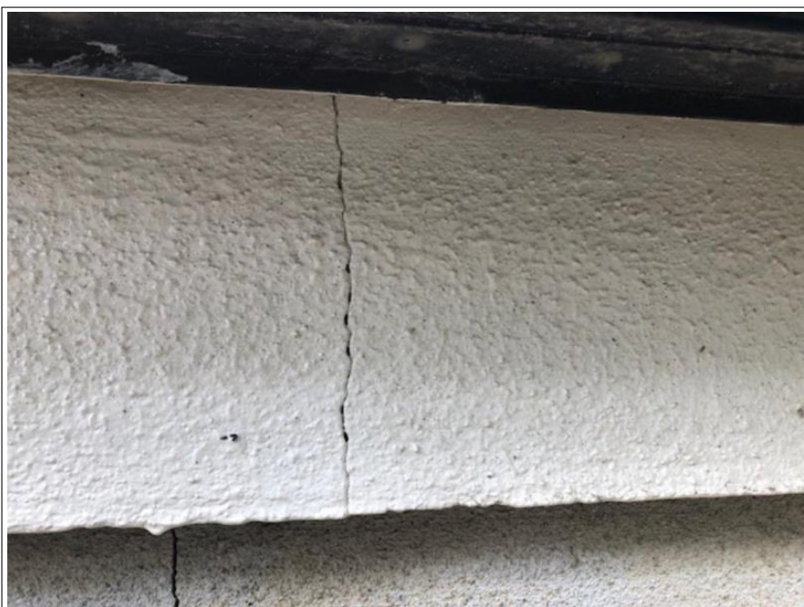
外壁 クラック部
