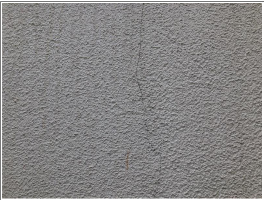
外壁 クラック部
