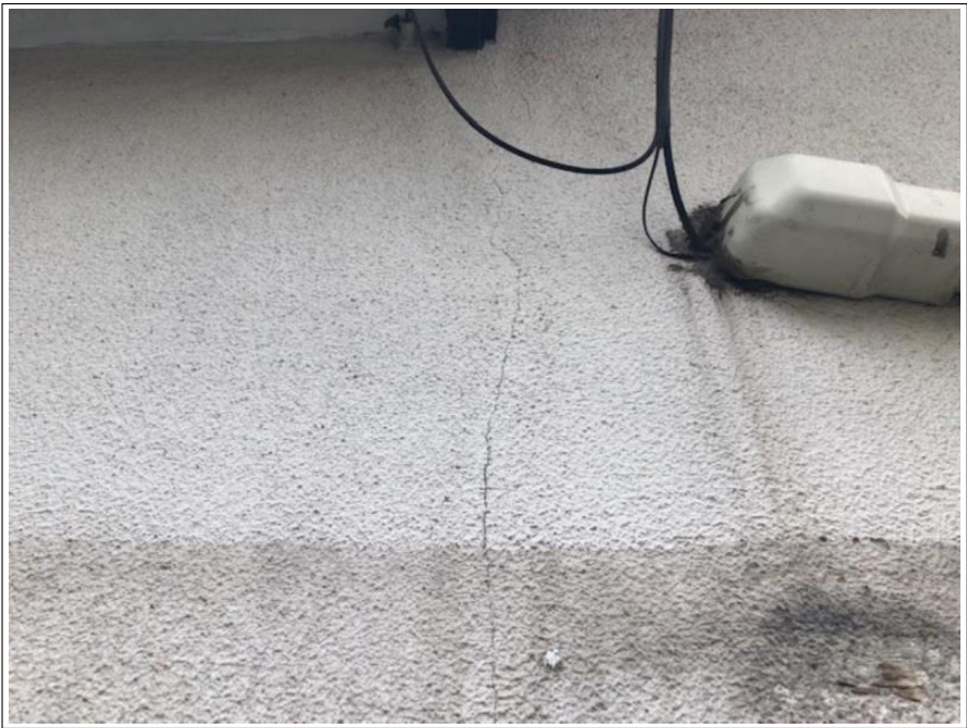
外壁 クラック部
