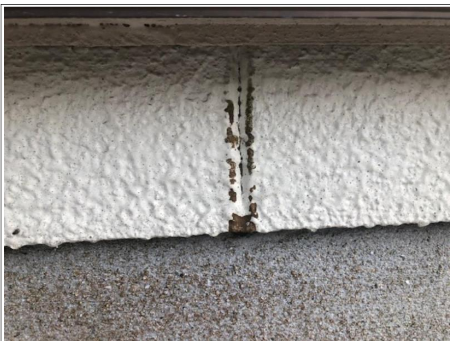
外壁 カビ発生
