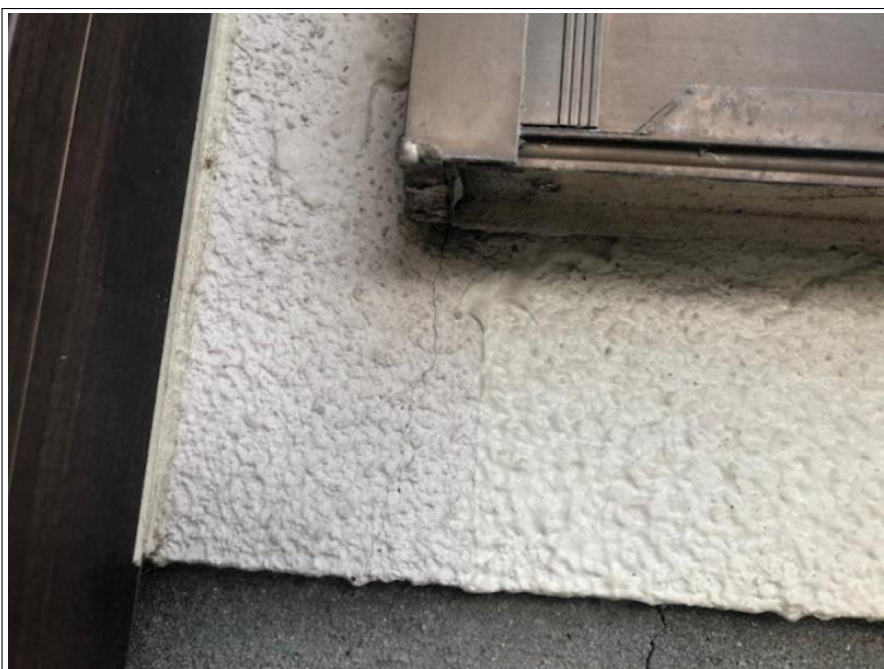
外壁 クラック部
