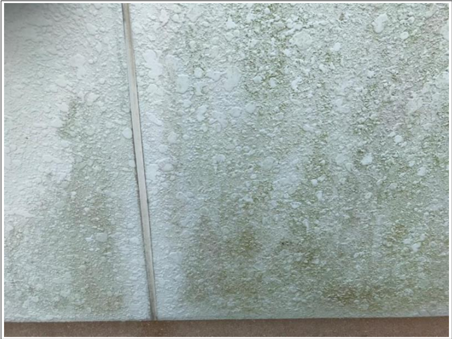
外壁 カビ発生部
