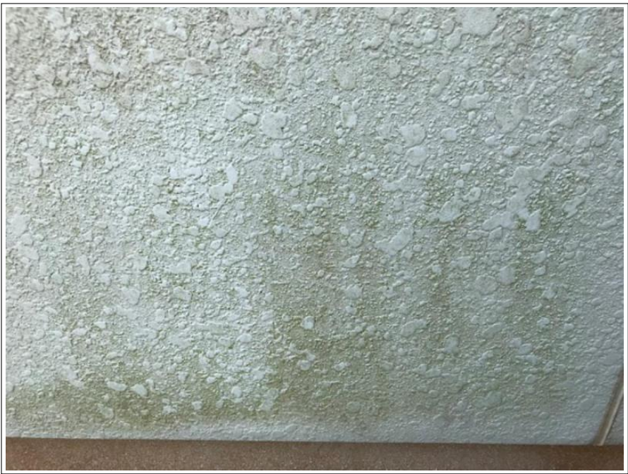
外壁 カビ発生部
