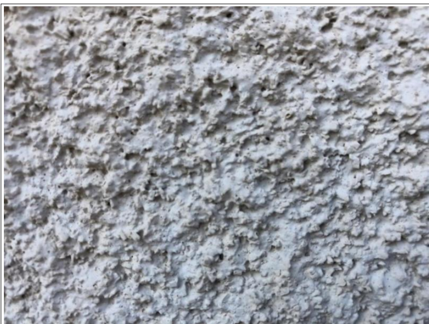
外壁 ピンホール
