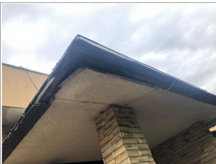
玄関 軒天井 破損部
