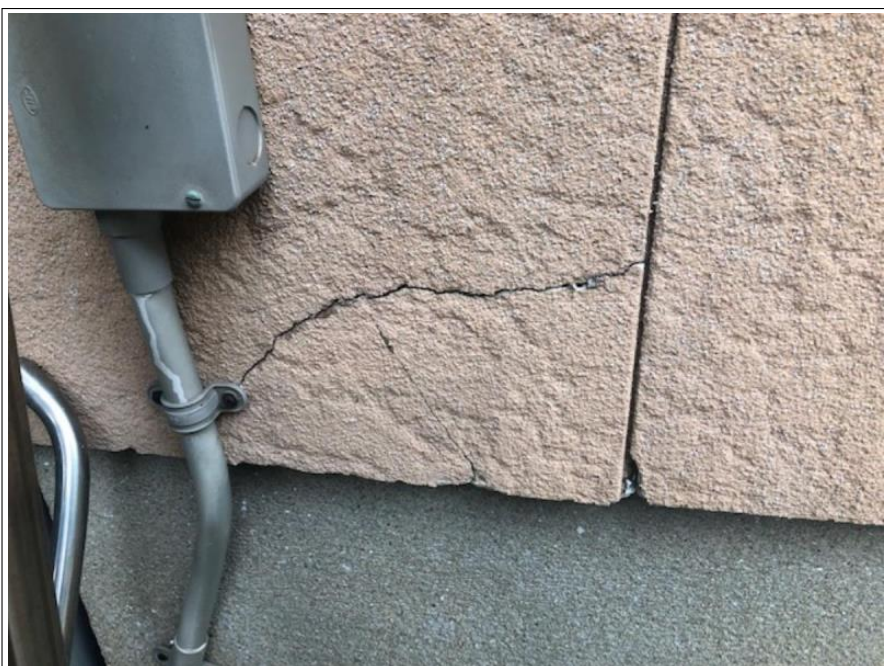
外壁 クラック部
