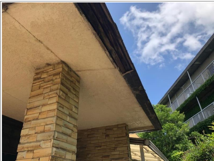
玄関 軒天井 破損部
