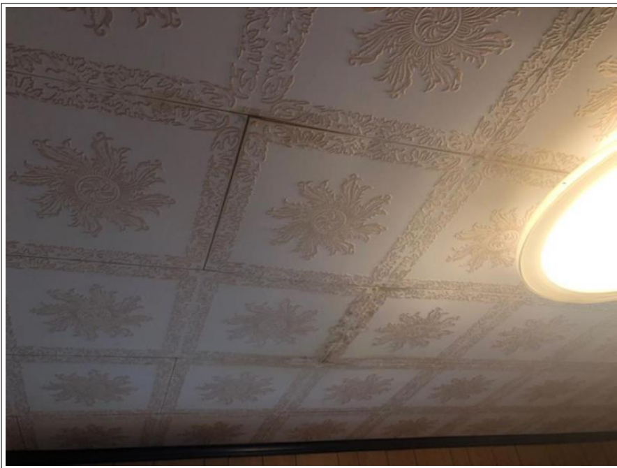
内部天井 雨漏れ
