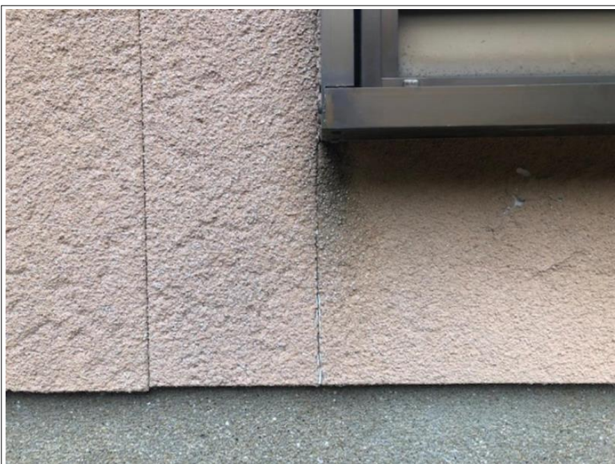
外壁 クラック部
