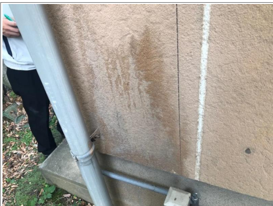
外壁 カビ発生部
