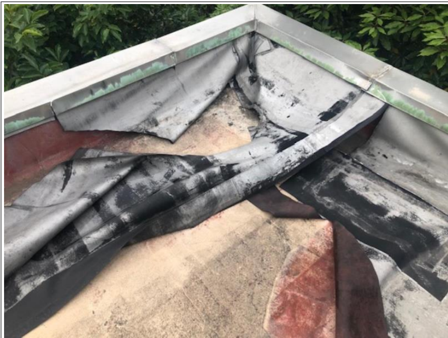
屋上防水部 旧防水シート剥離部
