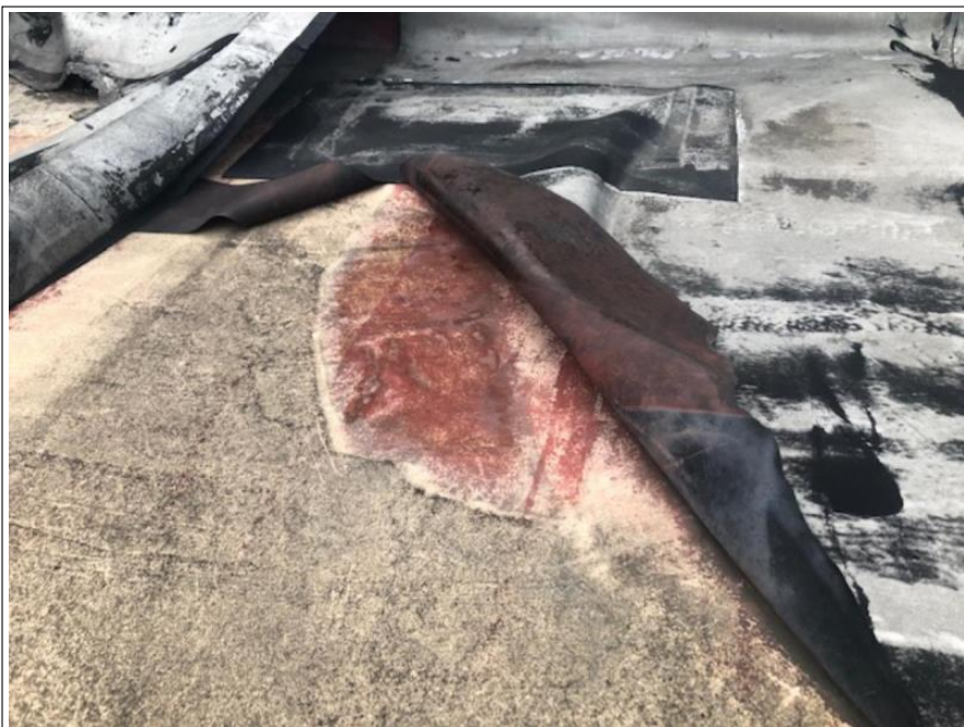
屋上防水部 旧防水シート剥離部
