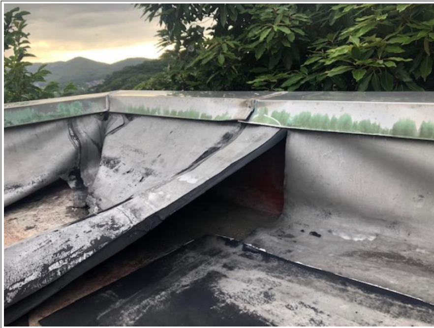
屋上防水部 旧防水シート剥離部
