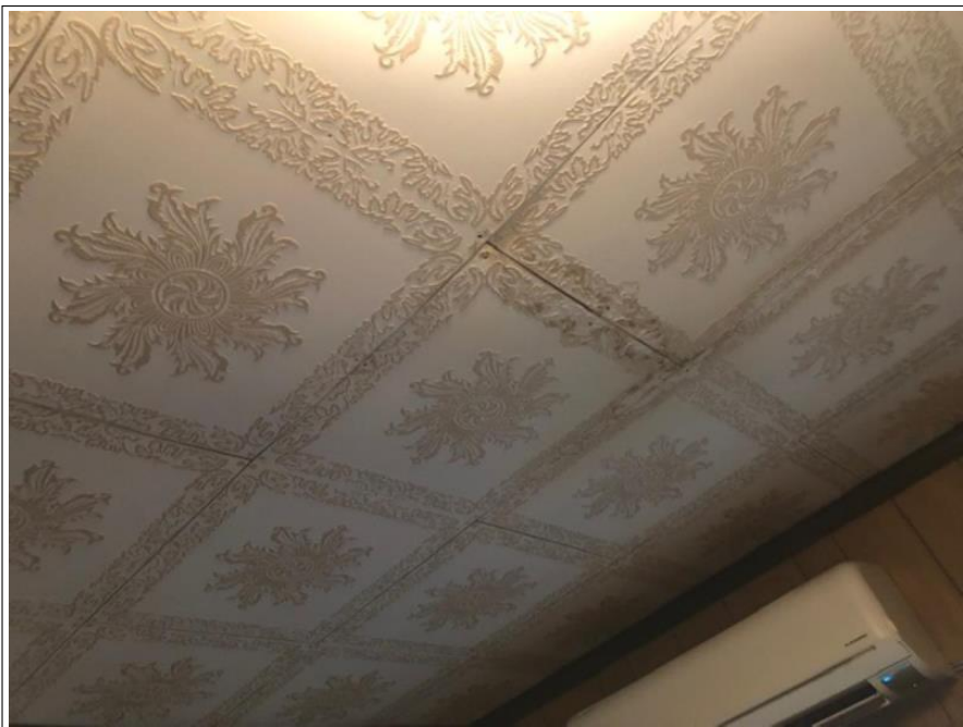
内部天井 雨漏れ
