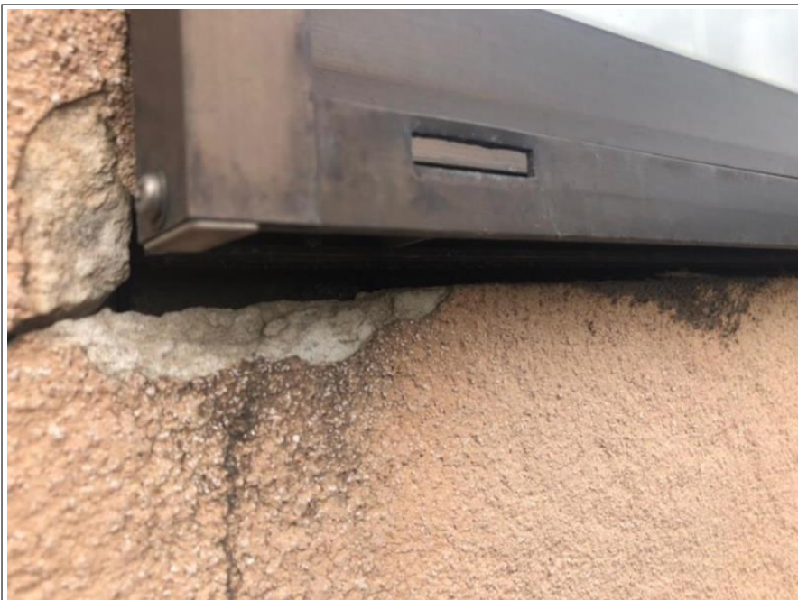
外壁 クラック部
