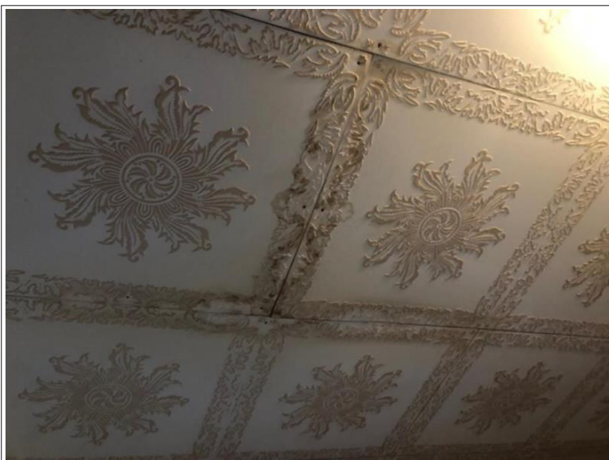
内部天井 雨漏れ
