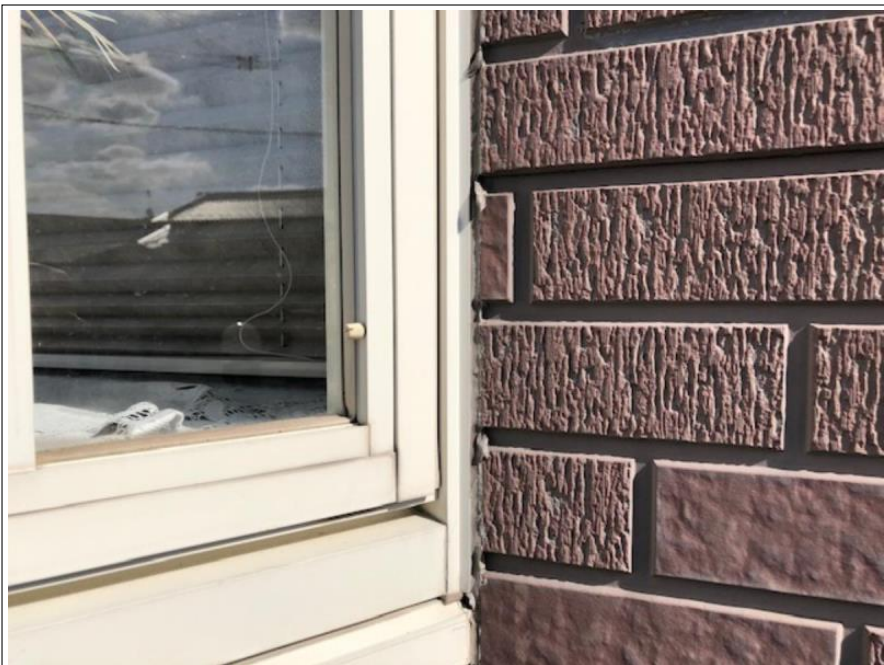
外壁 サッシ廻りシーリング部
