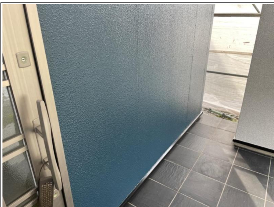
施工後 (6.10) 膨れ確認
