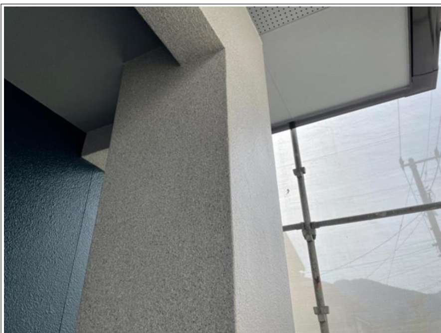
施工後 (6.10) 膨れ確認
