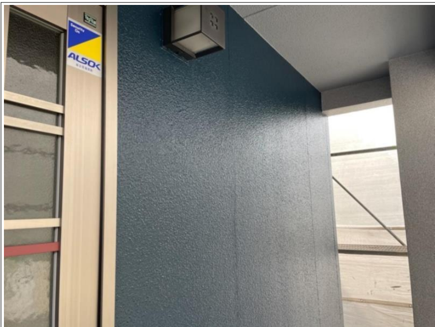
施工後 (6.10) 膨れ確認
