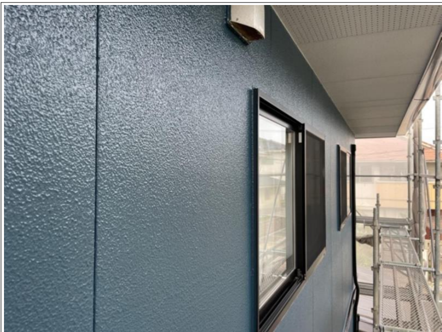
施工後 (6.10) 膨れ確認
