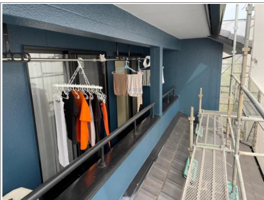
施工後 (6.10) 膨れ確認
