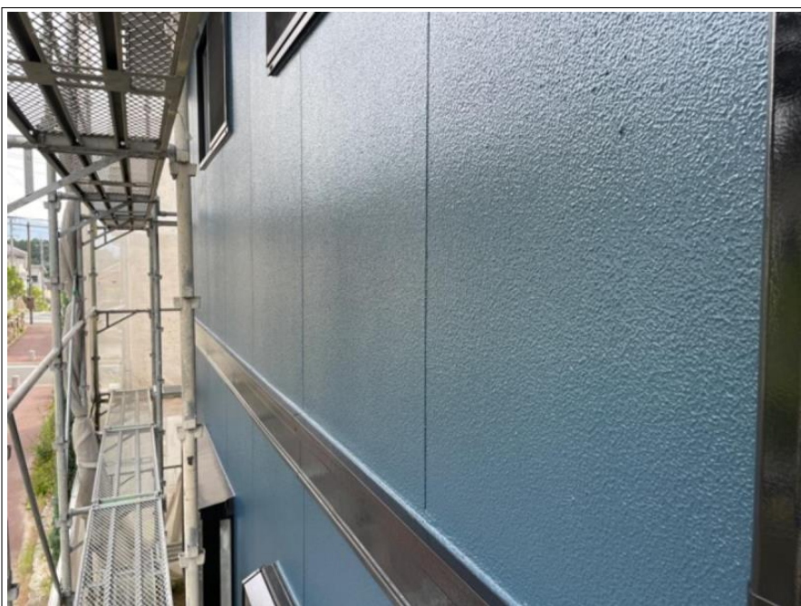
施工後 (6.10) 膨れ確認
