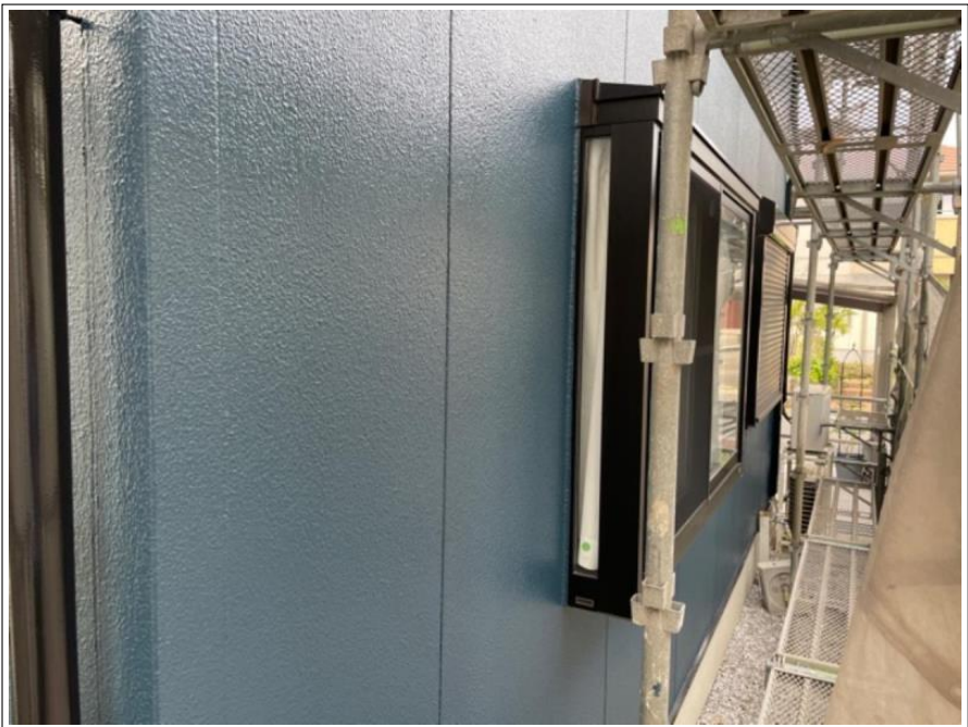
施工後 (6.10) 膨れ確認
