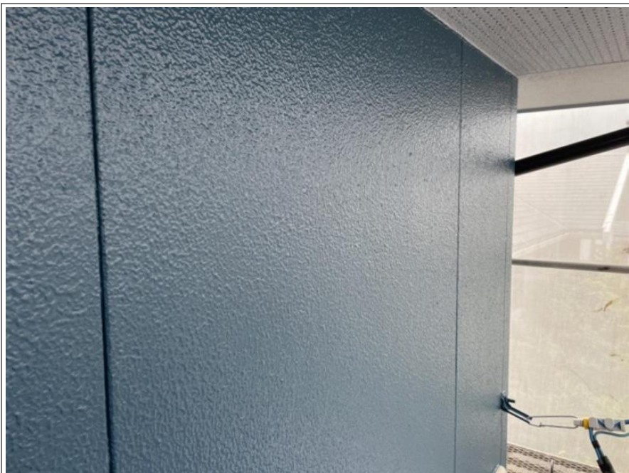
施工後 (6.10) 膨れ確認
