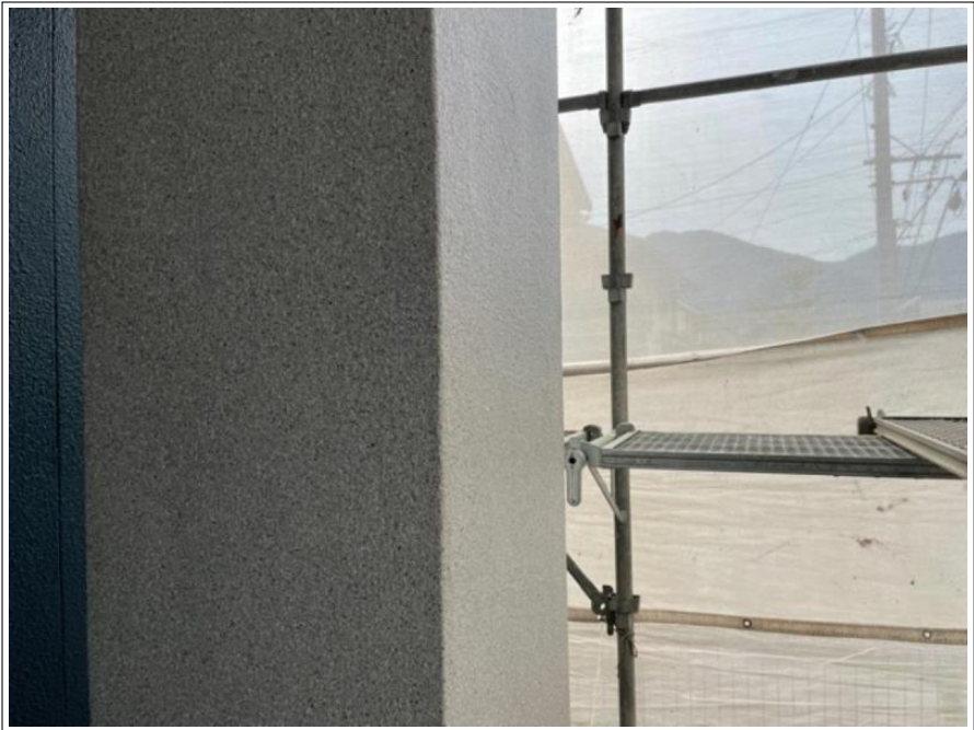
施工後 (6.10) 膨れ確認
