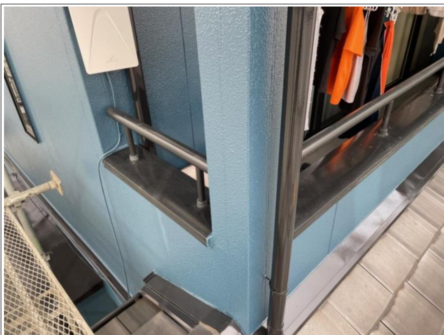
施工後 (6.10) 膨れ確認
