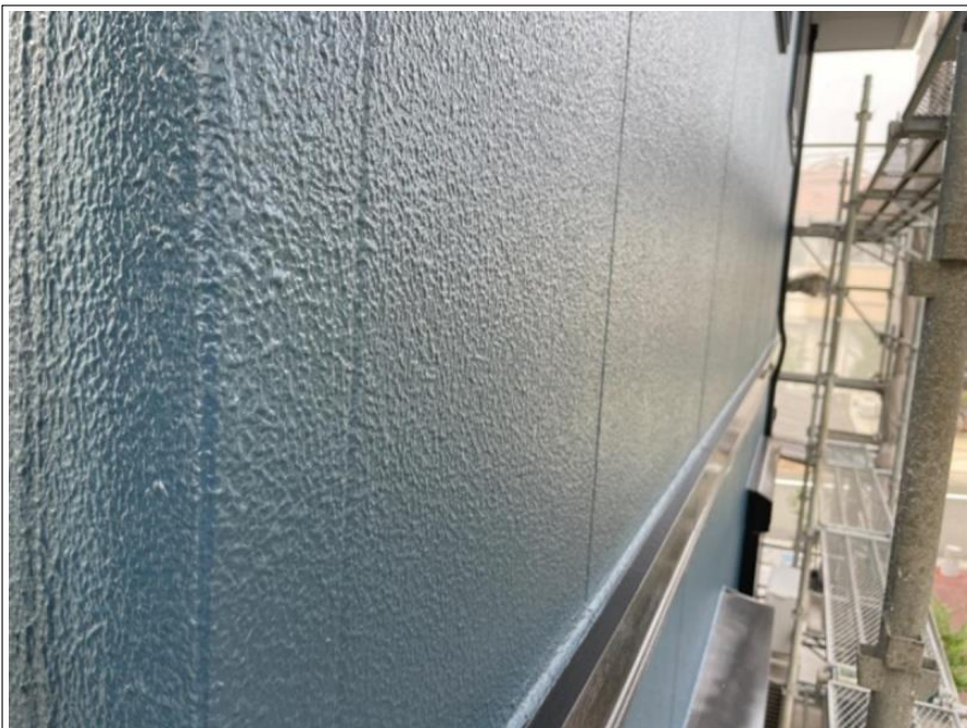
施工後 (6.10) 膨れ確認
