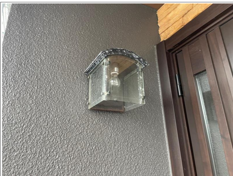
玄関 照明器具
