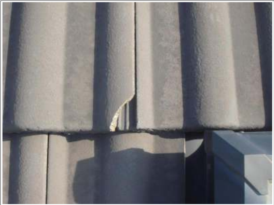
屋根クラック補修施工前
