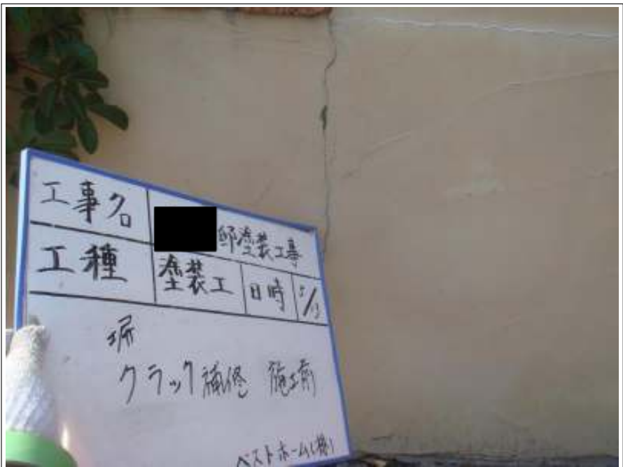
塀クラック補修施工前
