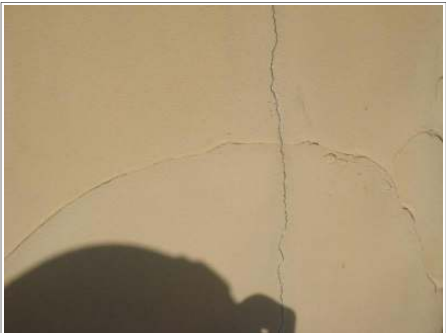
塀クラック補修施工前
