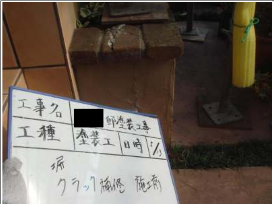
塀クラック補修施工前
