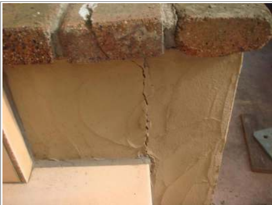
塀クラック補修施工前
