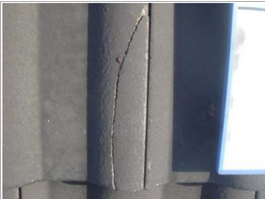
屋根クラック補修施工前
