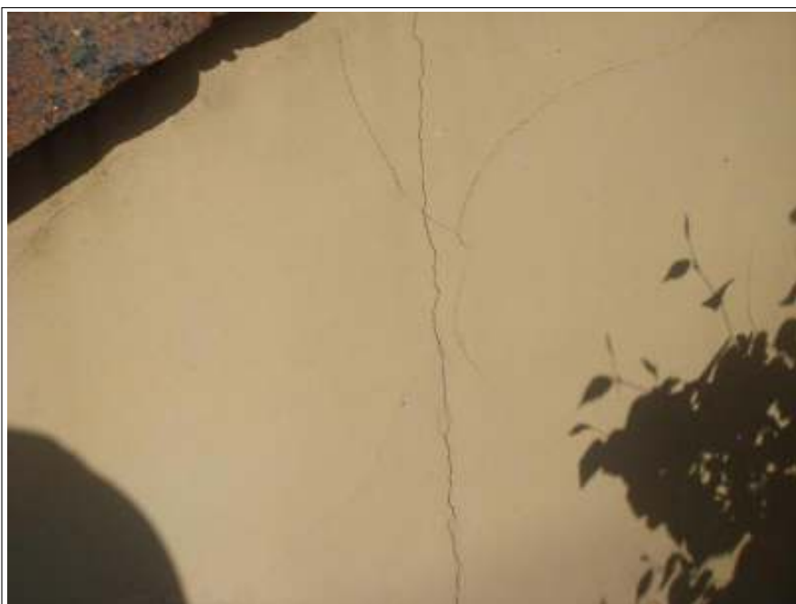
塀クラック補修施工前
