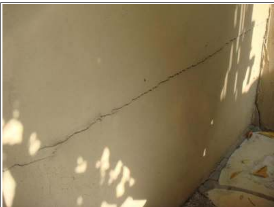
塀クラック補修施工前
