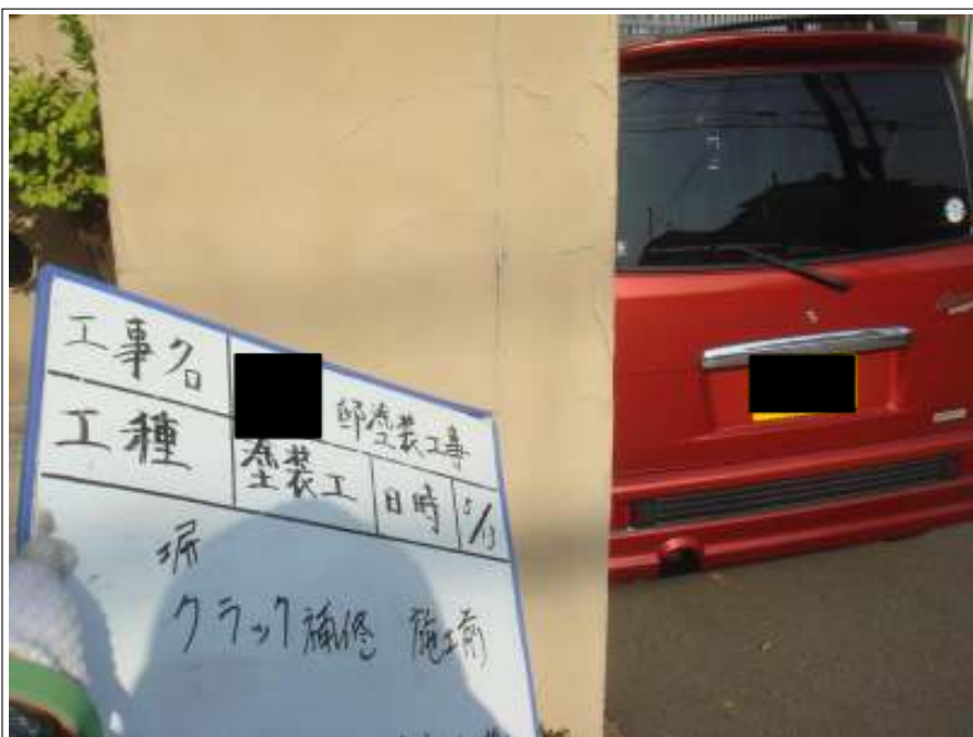
塀クラック補修施工前
