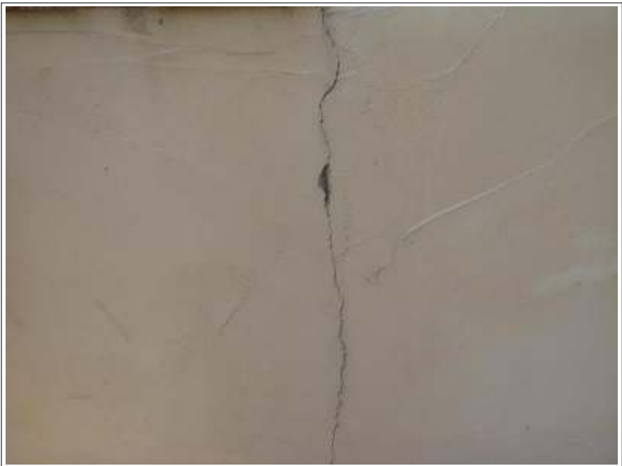
塀クラック補修施工前
