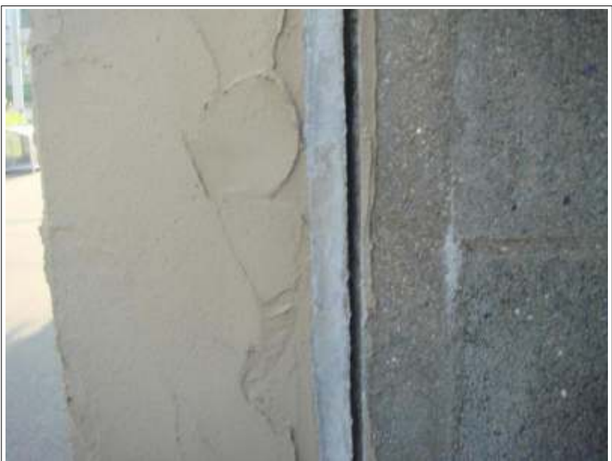
塀クラック補修施工前
