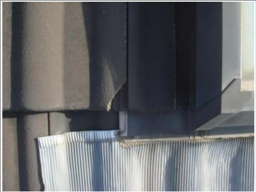
屋根クラック補修施工前
