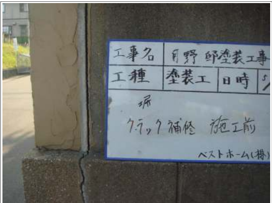
塀クラック補修施工前
