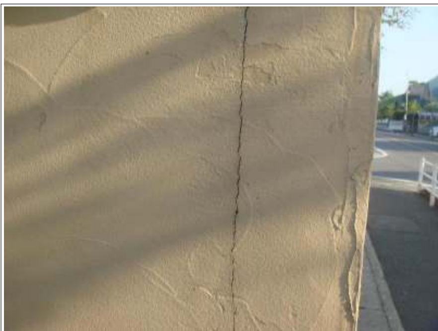
塀クラック補修施工前
