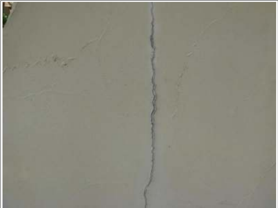
塀クラック補修施工前
