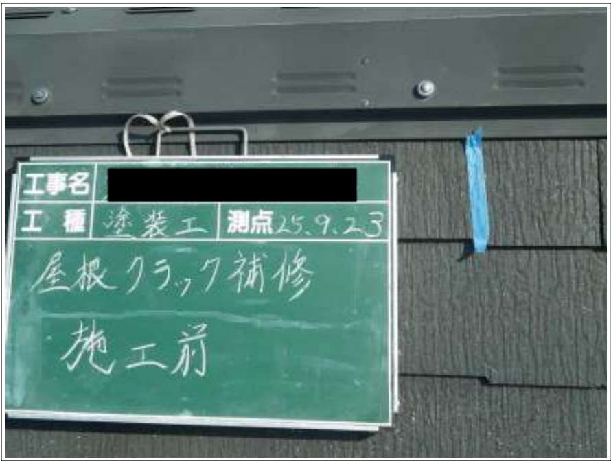
屋根クラック補修施工前
