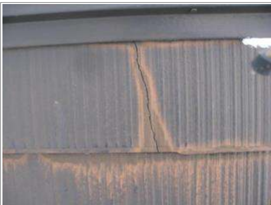
クラック補修施工前
