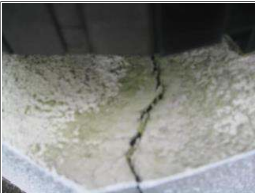
クラック補修施工前
