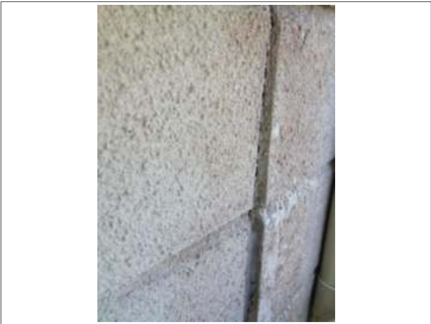
外壁シーリング劣化部
