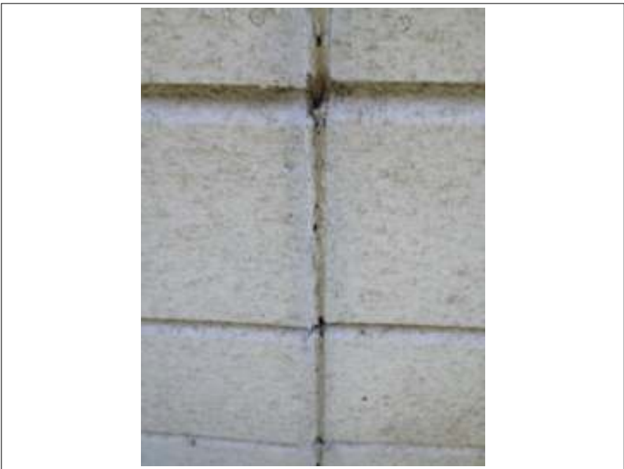
外壁シーリング劣化部
