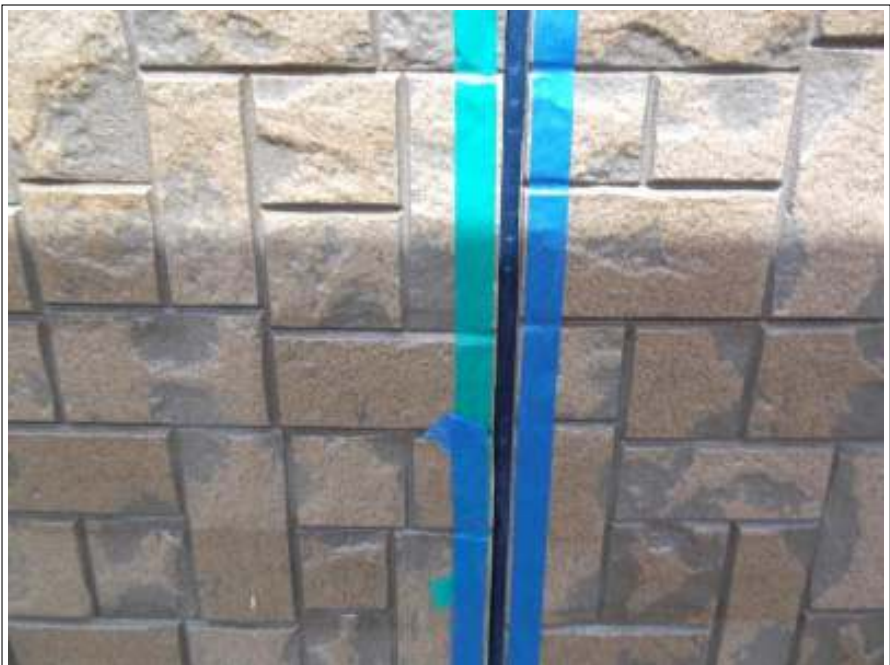
外壁コーキング補修施工前
