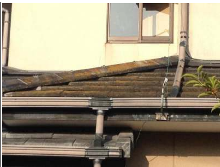
屋根 洋風セメント瓦 カビ発生部
