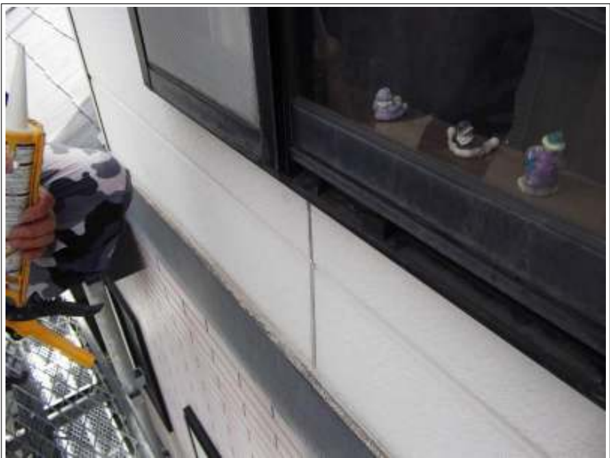
外壁 シーリング打替え施工前
