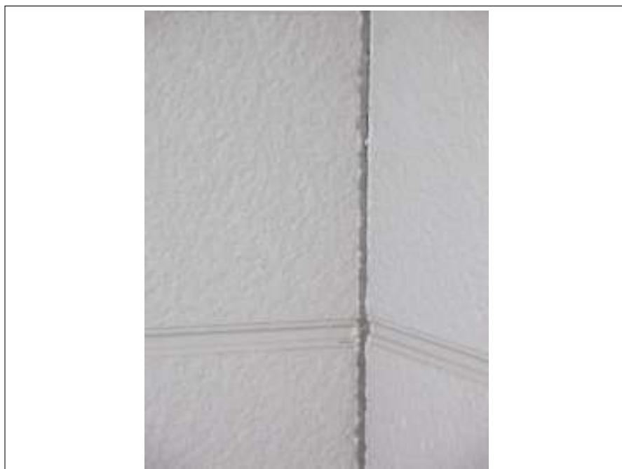
外壁 シーリング打替え施工前
