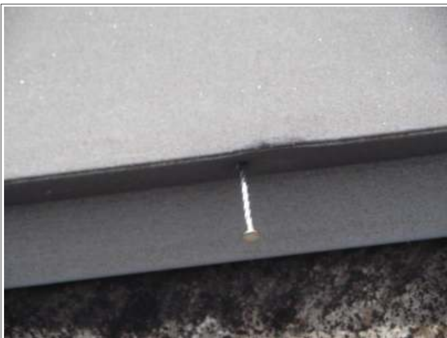
棟鉄板 補修前
