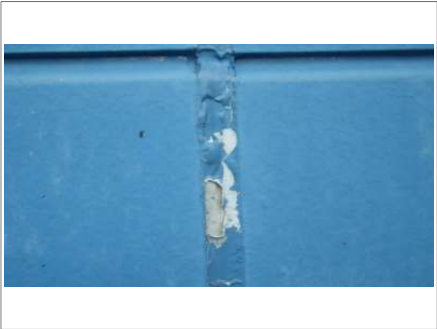
外壁シーリング打替え施工前
