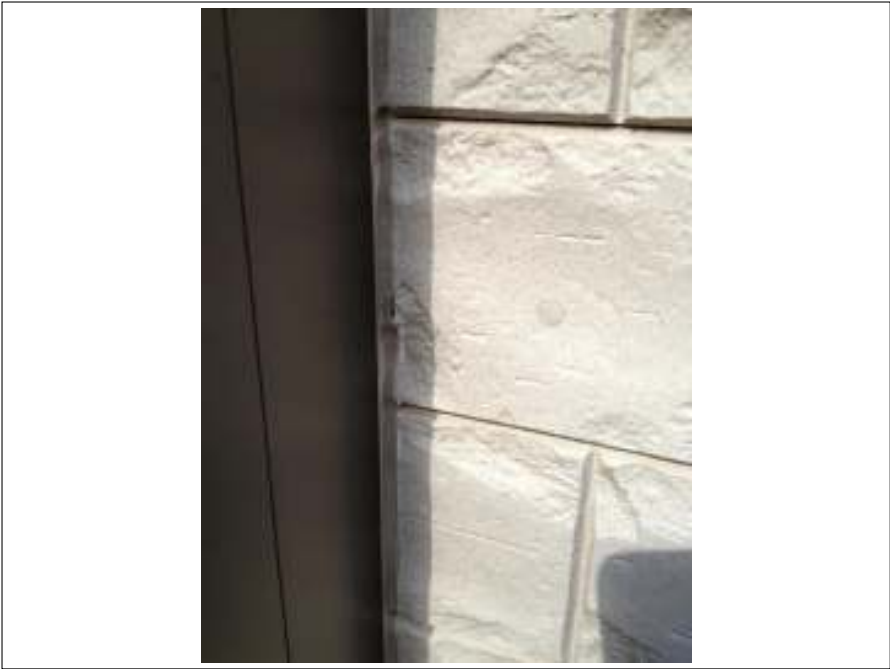
サッシ廻りシーリング劣化部
