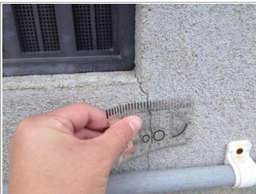
基礎 クラック部
