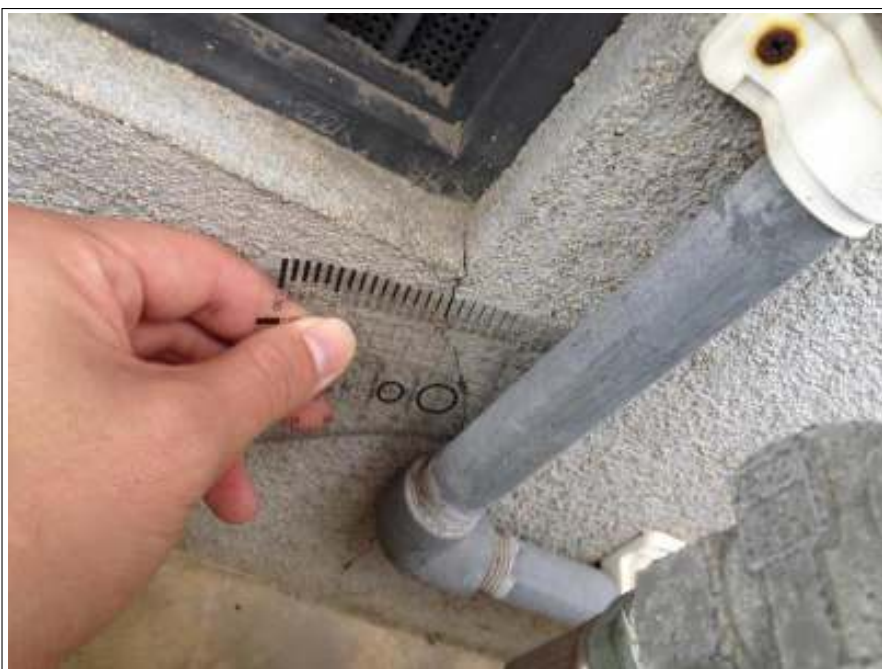
基礎 クラック部
