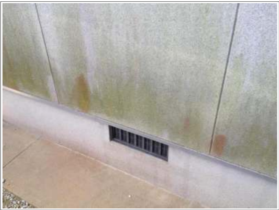
外壁カビ発生部
