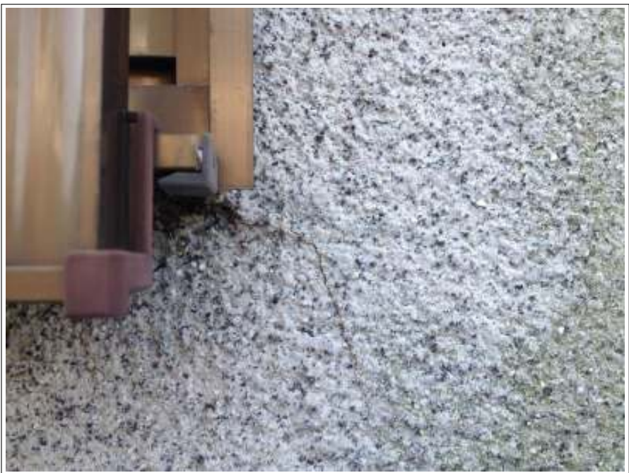
外壁 クラック部
