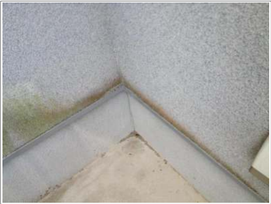
外壁カビ発生部
