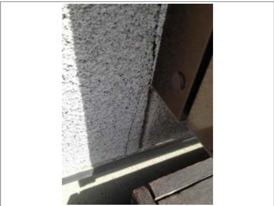
外壁 クラック部
