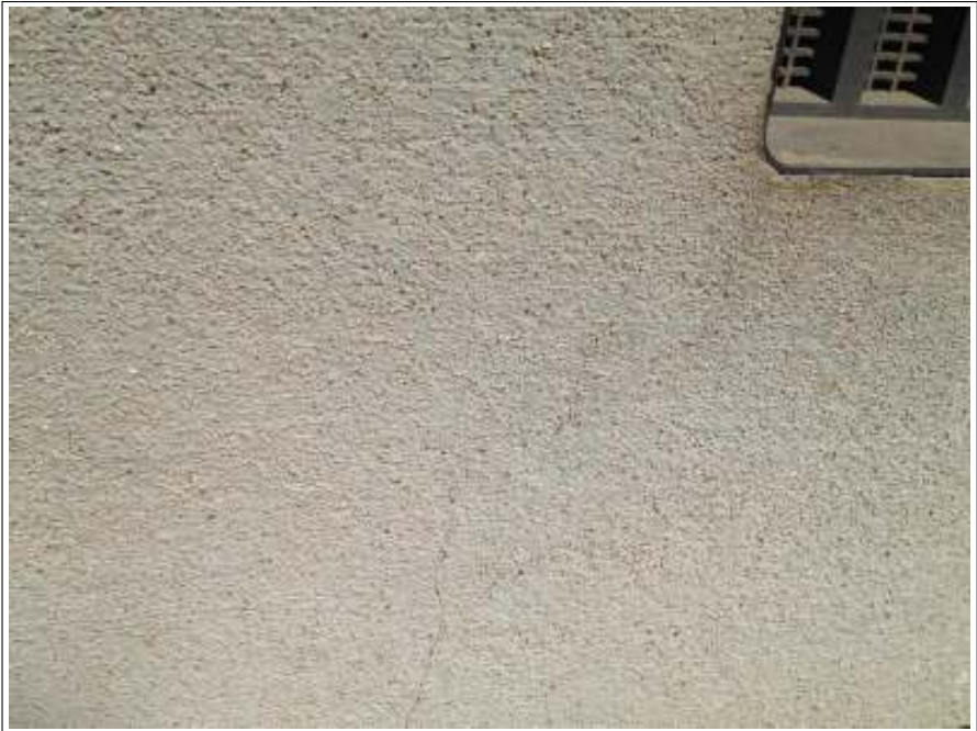
基礎 クラック
