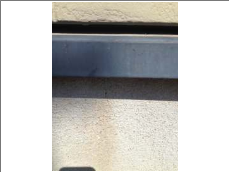
基礎 クラック
