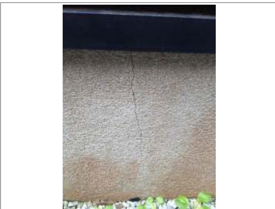
基礎 クラック
