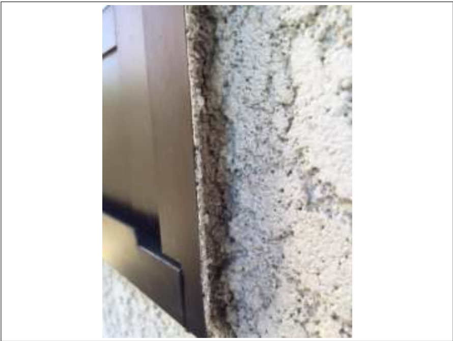
サッシ廻りシーリング劣化部
