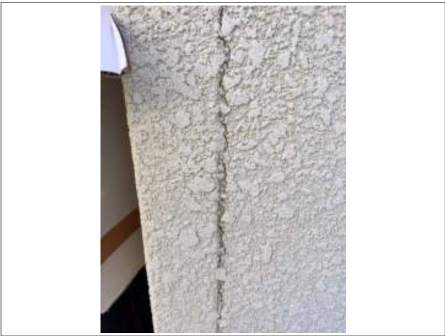
外壁 クラック部
