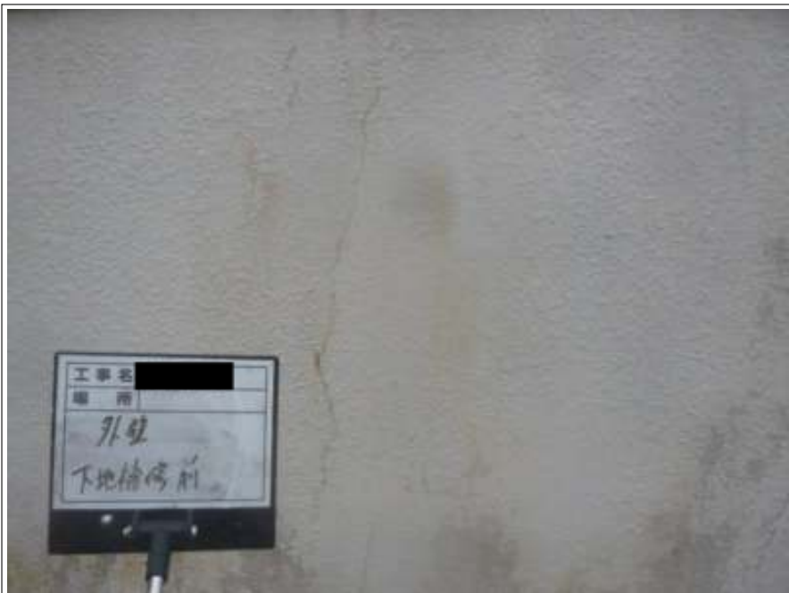
外壁 クラック補修施工前
