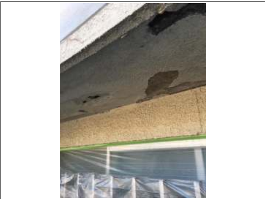
軒天 爆裂部 補修前
