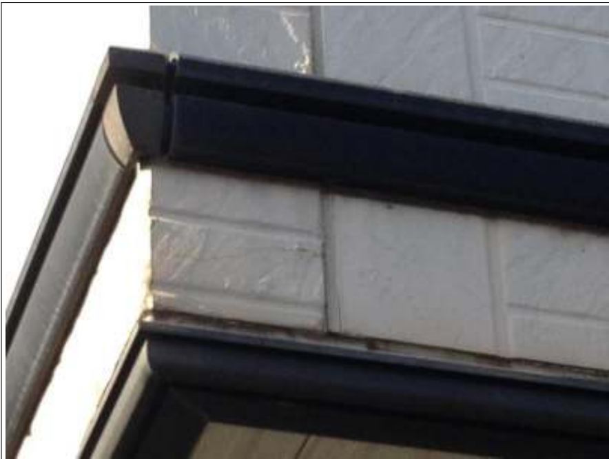
外壁 クラック部
