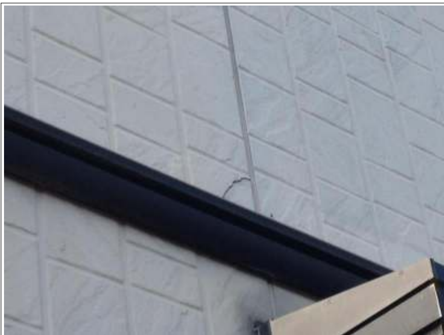
外壁 クラック部
