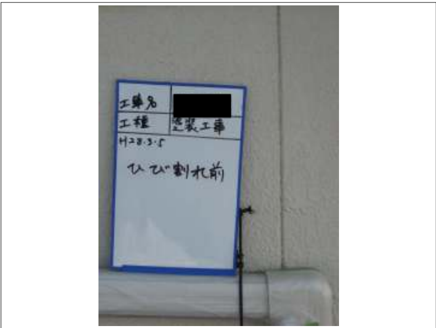
外壁 クラック補修施工前
