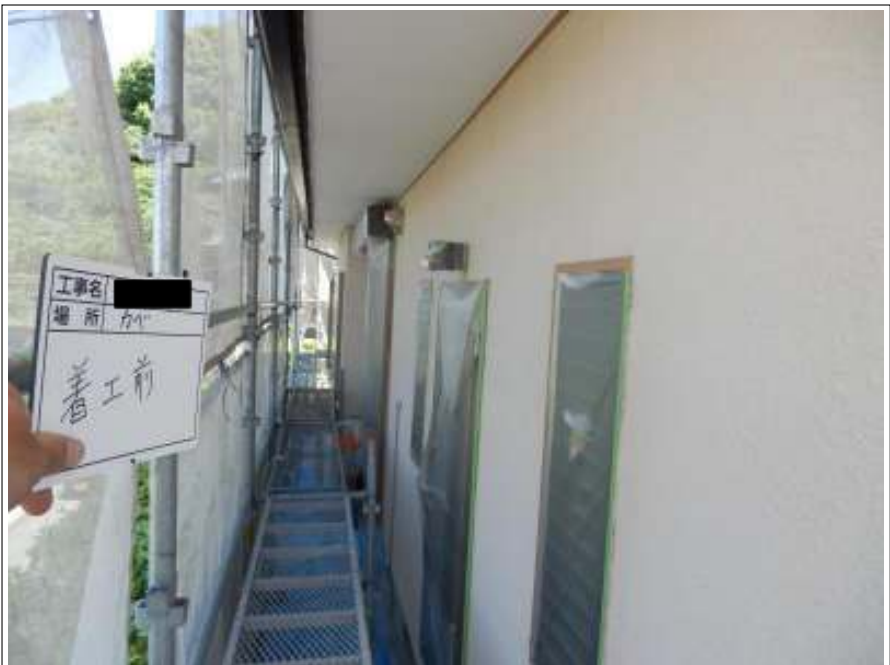
外壁（2F） 施工前
