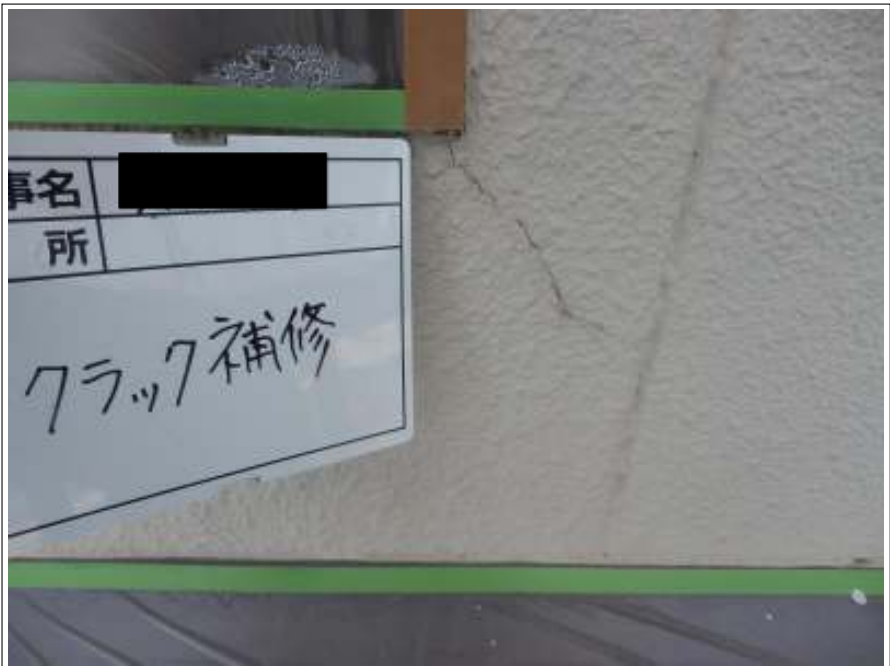
外壁 クラック補修施工前
