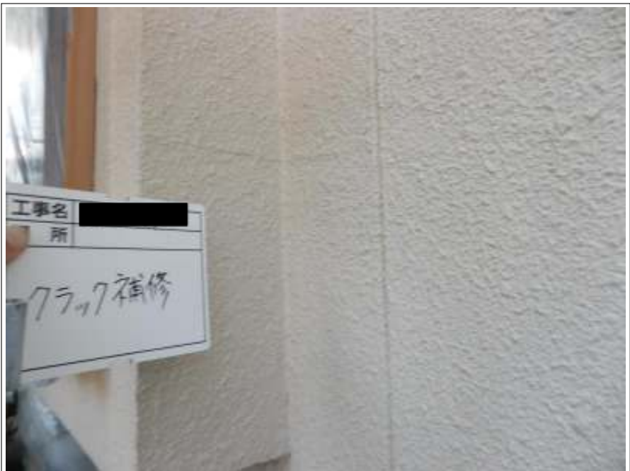
外壁 クラック補修施工前
