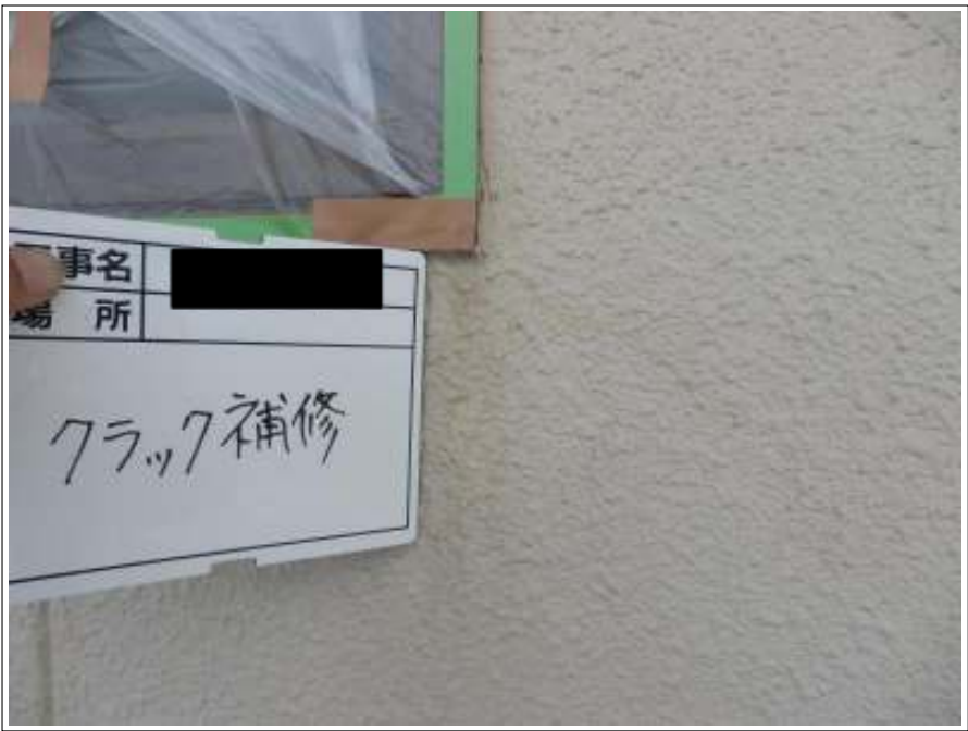
外壁 クラック補修施工前
