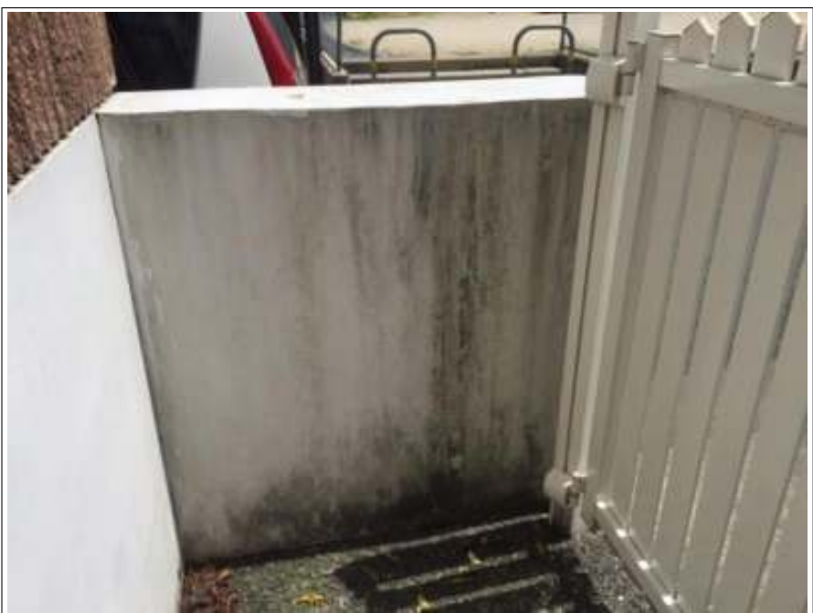
塀 カビ発生部
