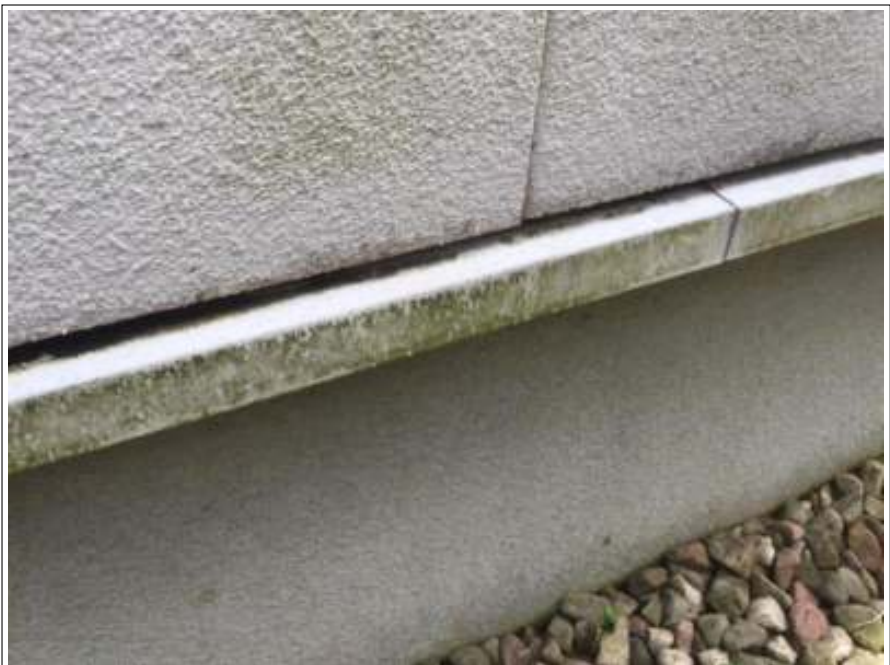
水切り カビ発生部
