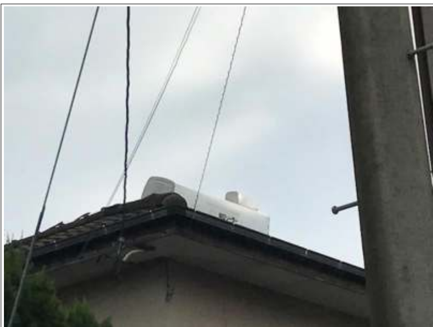
屋根 太陽熱温水器
