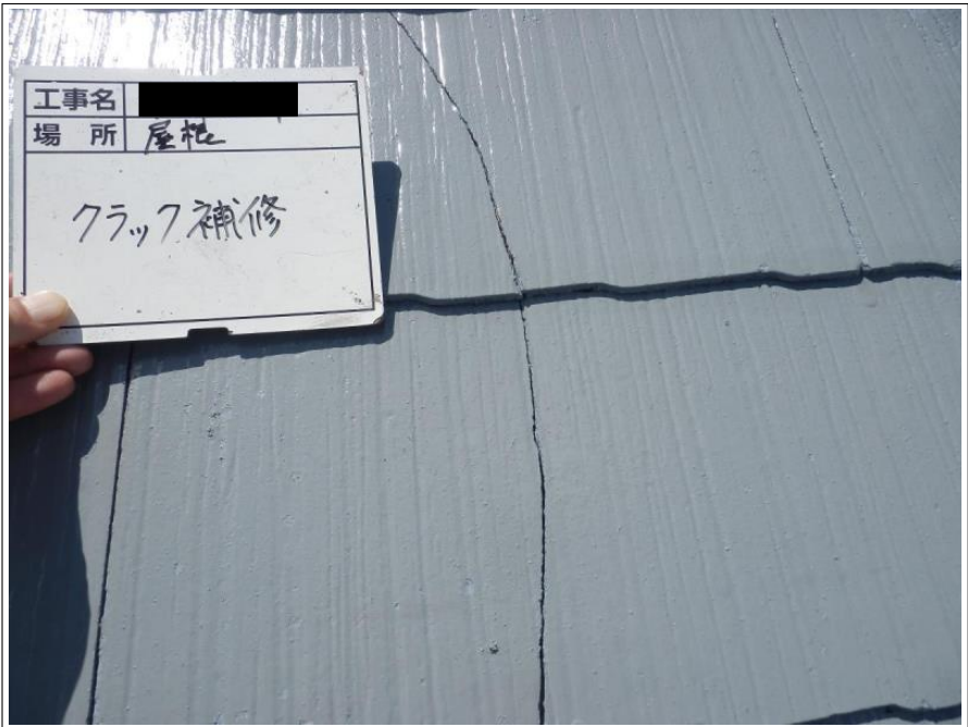
屋根 クラック補修
