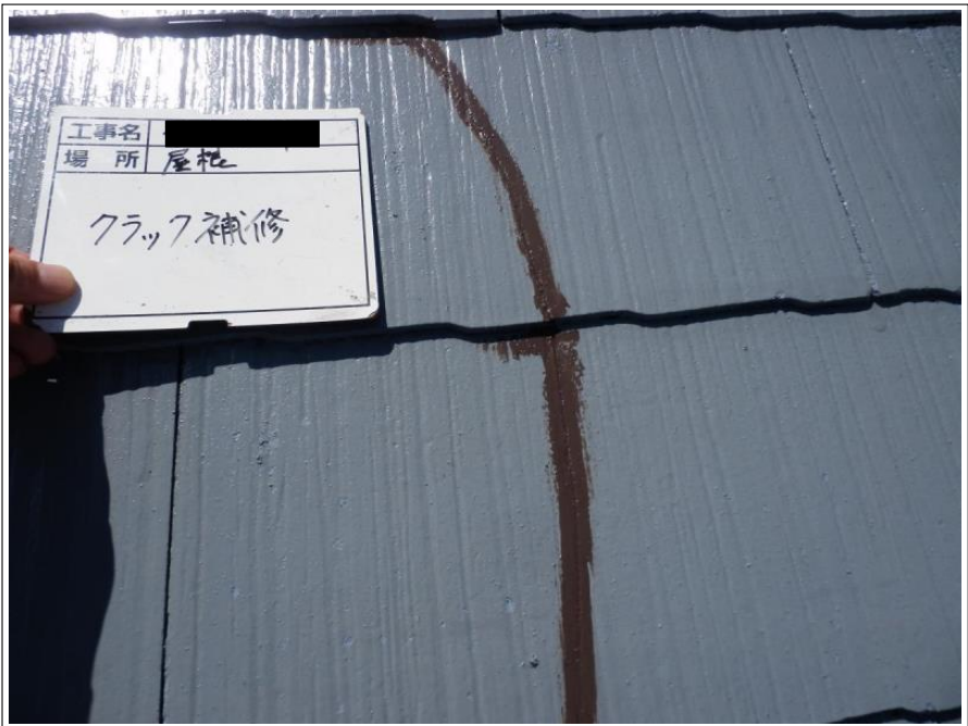
屋根 クラック補修
