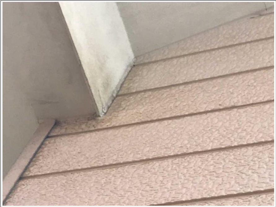
入隅シーリング 劣化部
