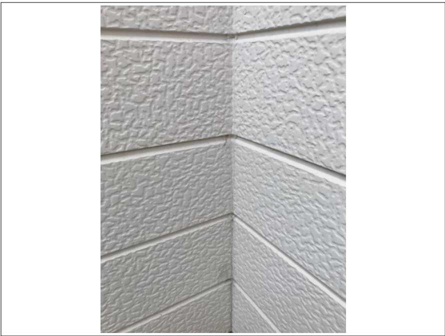
入隅シーリング 劣化部
