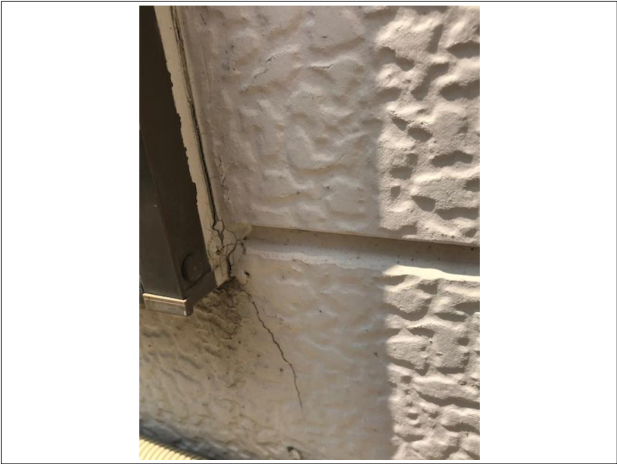
外壁 クラック部
