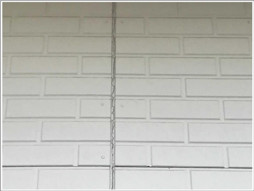
ボードシーリング 劣化部
