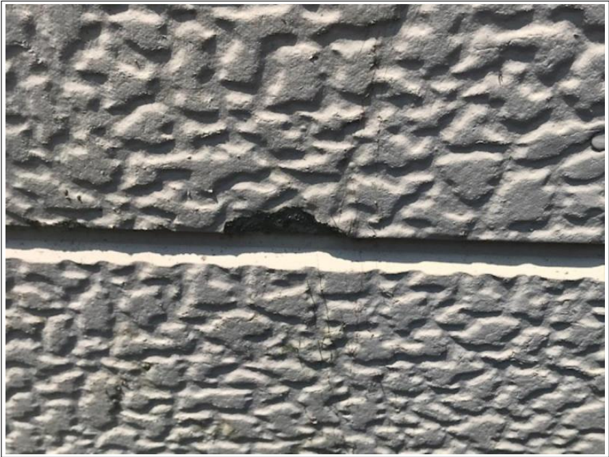
外壁 クラック部
