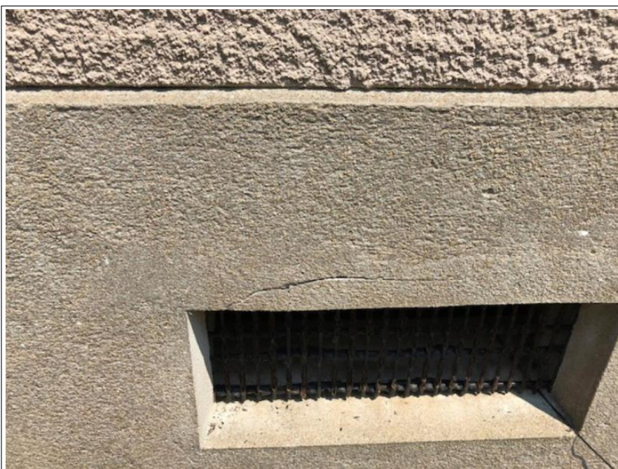
基礎 クラック
